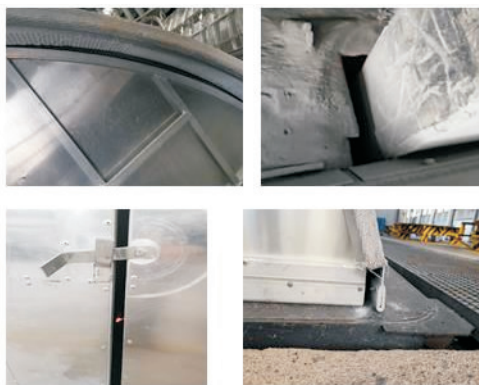
图3 电解槽现场密封情况
